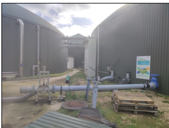
Figure 5. La canalisation permettant d'évacuer le digestat, résidu de la digestion en anaérobie, raccordée au digesteur.
