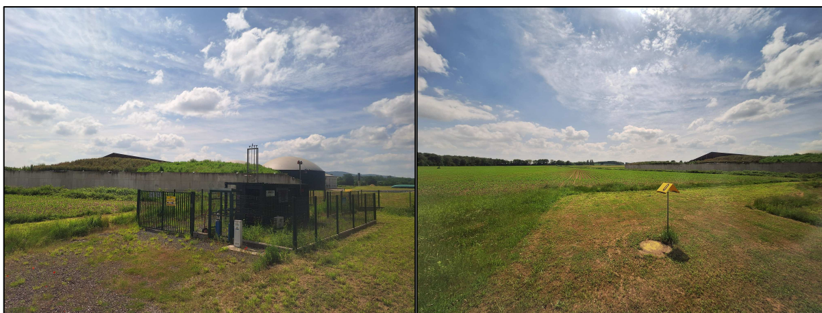
Figures 4 et 5. Poste d'injection de GRTgaz et borne GRTgaz marquant la présence du réseau de transport de gaz naturel, installés à proximité de l'installation de méthanisation
