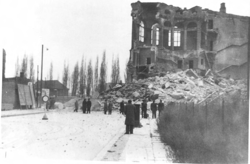
Figure 4.10 Demolishing the Museum für Völkerkunde, 1961, photographer unidentified, © Ethnologisches Museum der Staatlichen Museen zu Berlin – Preußischer Kulturbesitz
