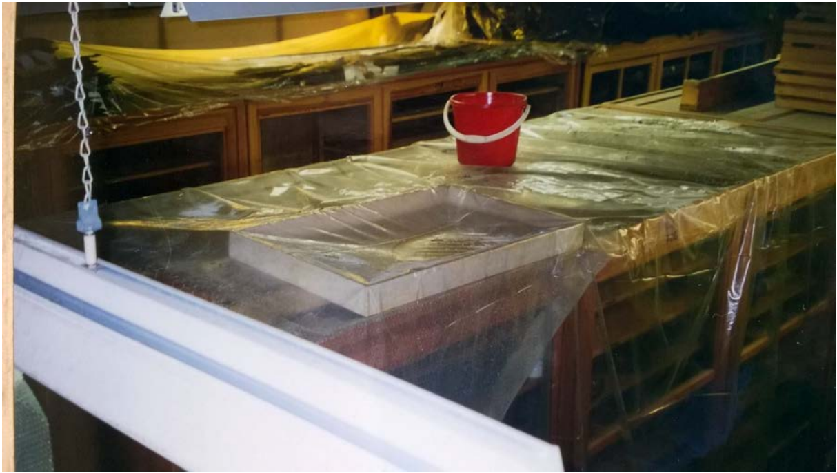
Figure 4.30 Protecting objects from the leaking roof, photograph by Hans-Joachim Radosuboff, © Ethnologisches Museum der Staatlichen Museen zu Berlin – Preußischer Kulturbesitz
