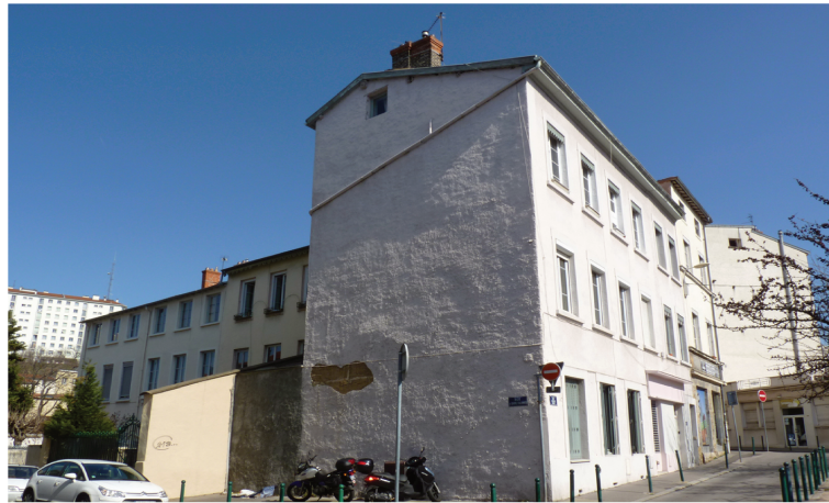
FIGURE 1-18 – Immeuble en pisé à Lyon, le décollement de l’enduit révèle le pisé (Photo Sébastien Moriset, CRAterre).
