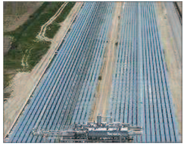
FIGURE 1.19: Photographie de la centrale solaire Puerto Errado de 1,4 MW e en Espagne [73]
