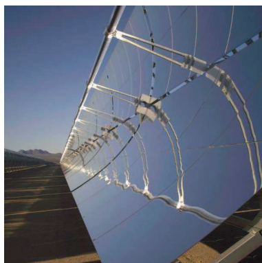
FIGURE 1.15: Photographie des concentrateurs cylindro-paraboliques de la centrale solaire Solar One de 72 MW e aux États Unis
