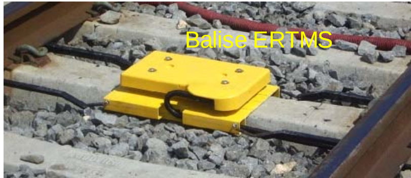
Fig. 1. 3. Balise ERTMS fixée sur la voie (www.mermecgroup.com)
